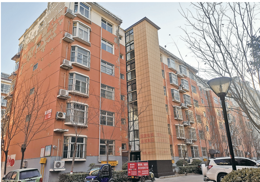
▲市区民生华庭小区安装完成的电梯 裴旭薇 摄
