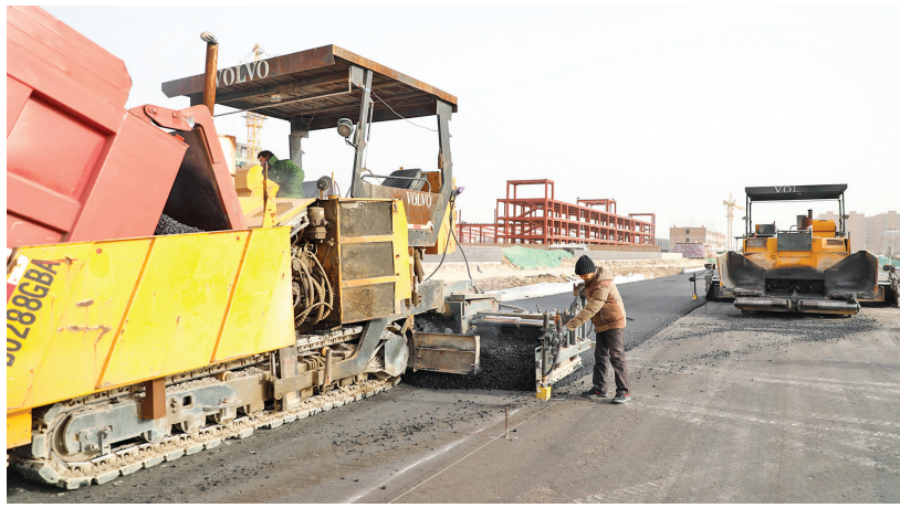
1月12日,工人在运城经开区安邑路道路工程项目工地实施路面铺油作业。该道路南起涑水街,北至大街街,建设总长度为1695.61米,修建完成后,将贯穿涑水街、纬四路、军屯街、大街街及沿线主要道路,有效减轻相关道路的交通压力,改善居民出行及生活环境。
