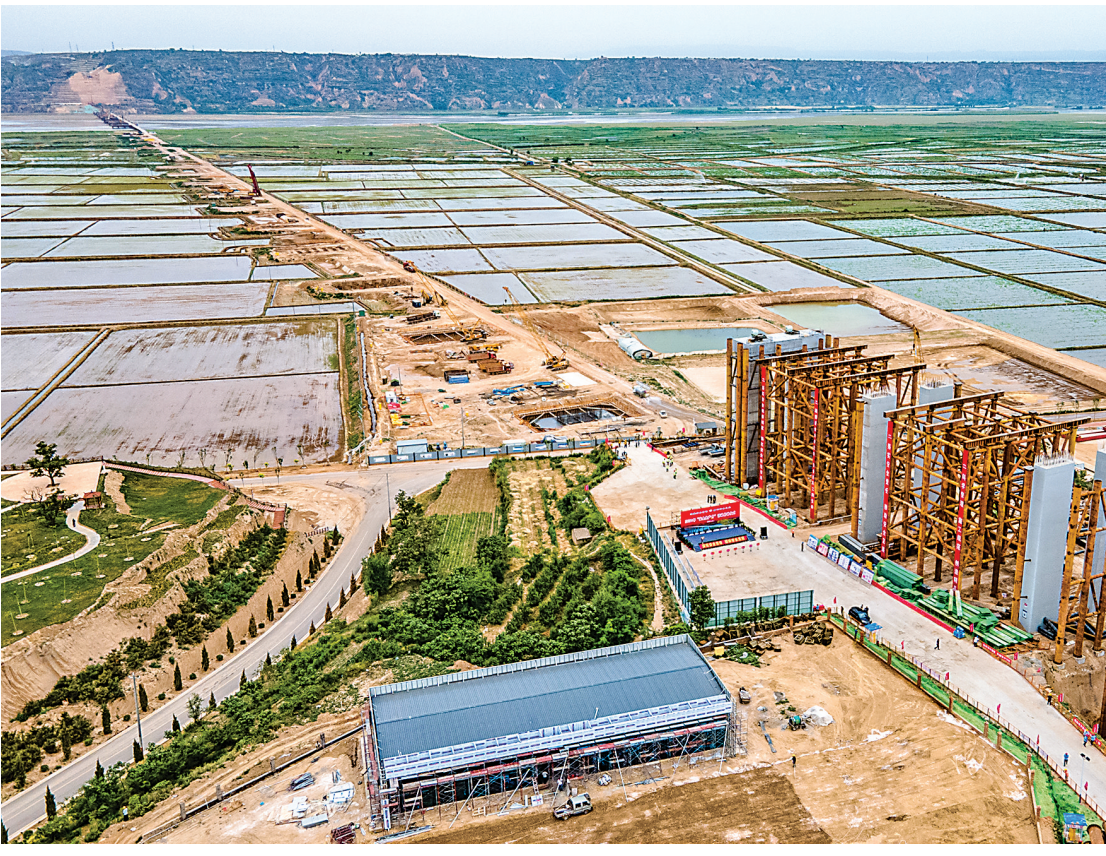
正在建设的临猗黄河大桥(6月13日摄)。临猗黄河大桥及引线工程是国家高速公路网菏宝线和山西省高速公路网及运城市公路网主骨架的重要组成部分,项目全长约21公里。其中,临猗黄河
