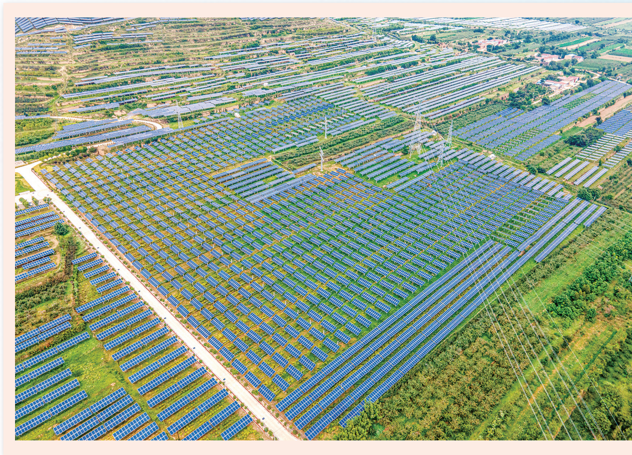
图为芮城县光伏领跑技术基地光伏一期项目现场 见习记者 陈方斌 摄
