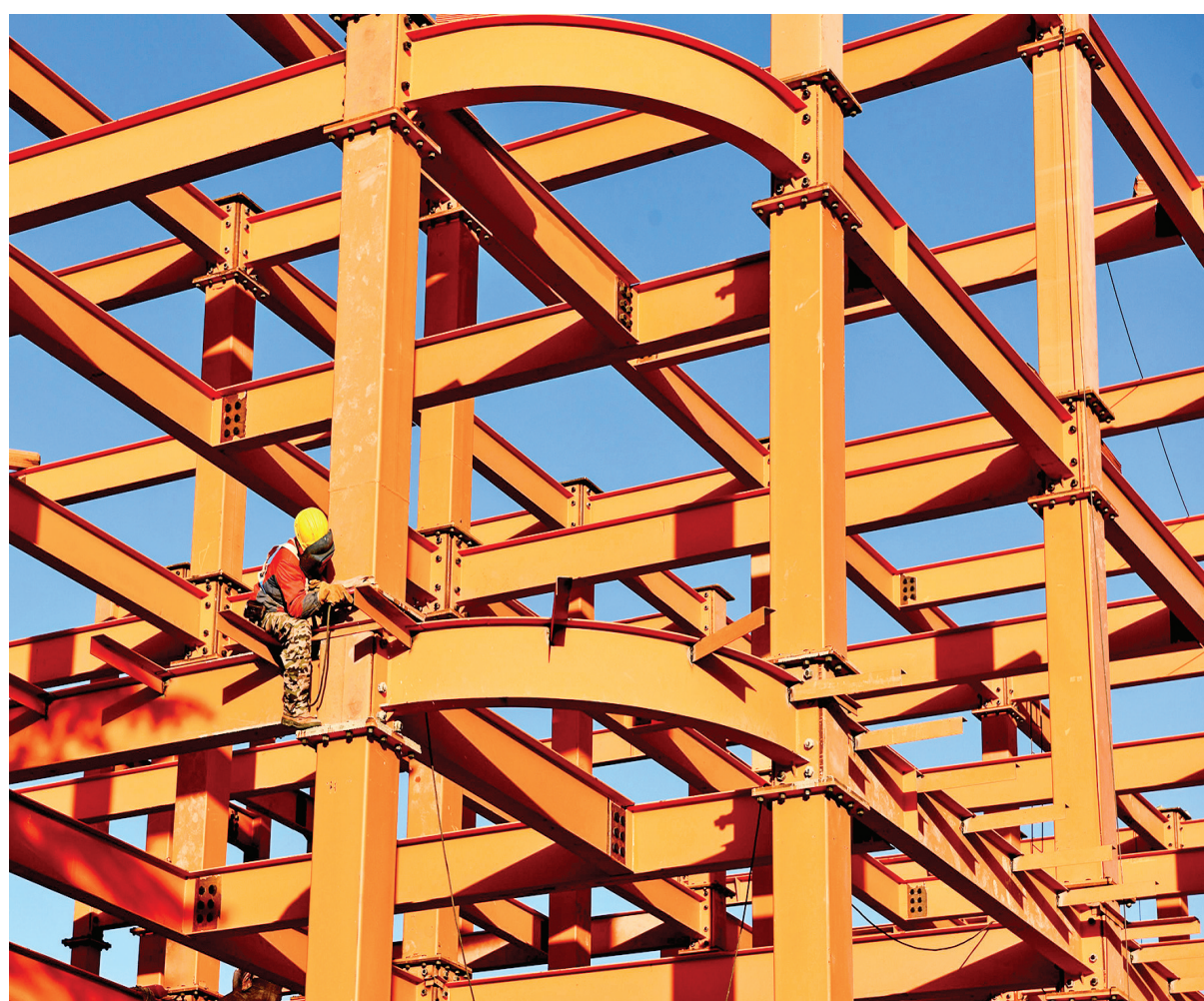
11月24日，在垣曲县城北初中学生公寓建设工地，工人在装配钢架上施工。这座公寓楼使用的是目前国内流行的钢筋桁架楼承板，安装简便速度快，具有抗震、抗火等性能。据悉，该校建设总投资1.98亿元，建筑面积3.9万平方米，装配率达到70%，预计明年9月初竣工使用。特约摄影 崔松良 摄
