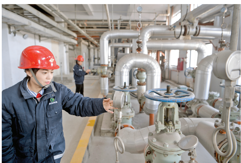
12月20日，天津市山西腾茂科技股份有限公司生产车间，技术员在查看设备运行情况。该公司成立于2007年，是目前国内最大的催化裂化催化剂生产企业，先后与山东理工大学、北京化工大学等开展合作，建立“产学研教学实践基地”，通过持续创新，实现公司技术不断升级，产品竞争力不断增强。 本报记者 冯英才 摄
