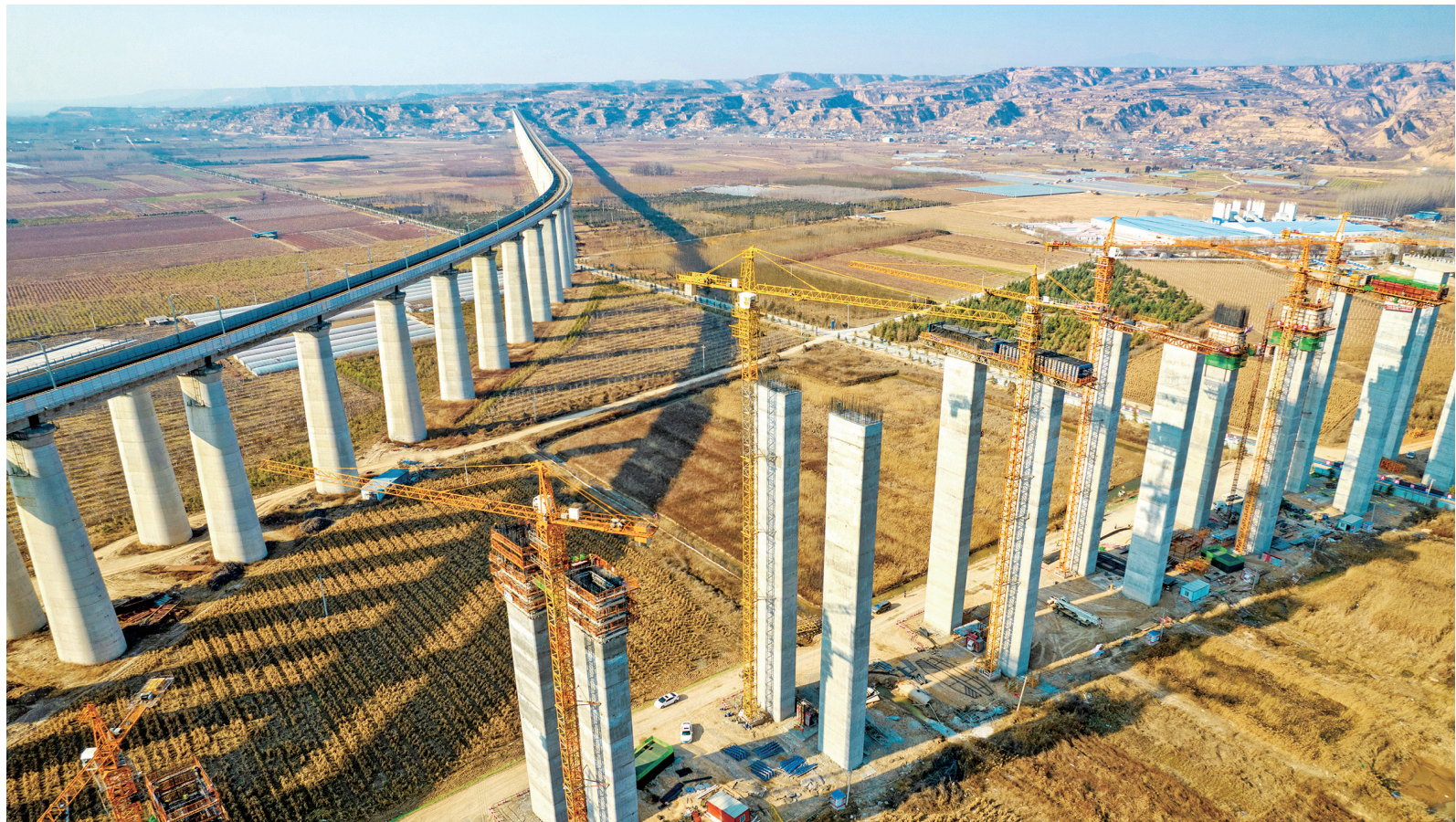
12月29日，运三高速公路三门峡大桥连接工程加紧施工。该连接线全长15.16公里，总投资28.41亿元，预计2023年建成建设投入使用。项目完成后，将实现山西运城、河南三门峡两地高速公路互联互通。
