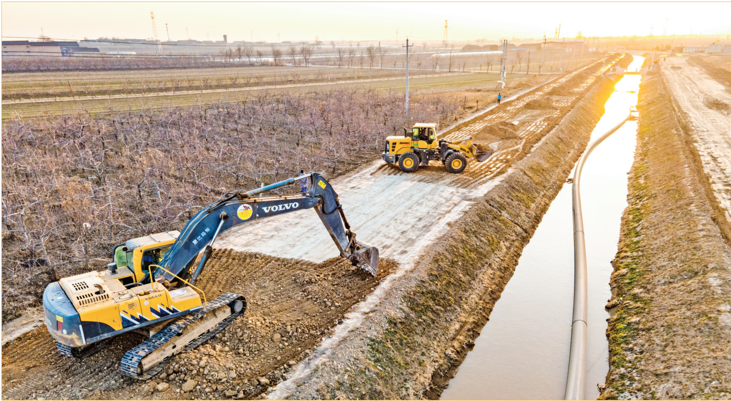
1月3日，沿涑水河田园风光示范带建设项目临猗段控污与清淤工程有序推进。沿涑水河田园风光示范带建设项目全长208公里，将通过流域内山水林田湖草沙等生态资源进行修复和治理，发掘沿线资源禀赋，盘活生态、文旅、康养、农业等相关产业要素，促进经济社会发展与资源环境承载力相协调，实现经济效益与生态效益的双赢。本报记者 陈方斌 摄
