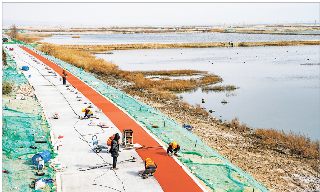
1月10日，盐湖生态修复工程岸边漫道项目施工现场，工人在铺设塑胶跑道。
