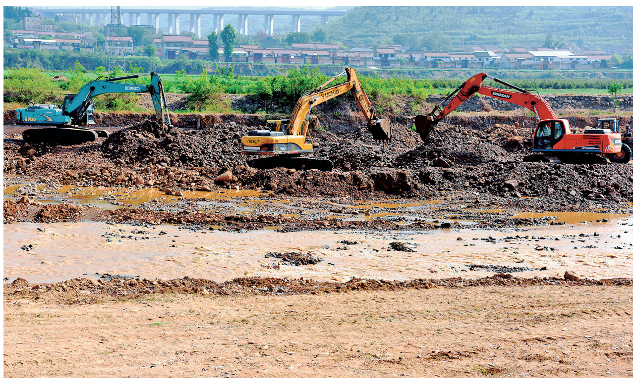
5月3日,垣曲县亮清河茅茨段疏浚工程现场。去年秋季的连续降雨使亮清河洪水泛滥,河道受阻。垣曲县立足防大汛保畅通,实施亮清河疏浚提升工程。该工程涉及河道24.3公里,目前已清理沙石55万立方米。工程完工后,将进一步提高河道行洪能力,保护两岸农田和村民安全。 特约摄影 崔松良 摄
