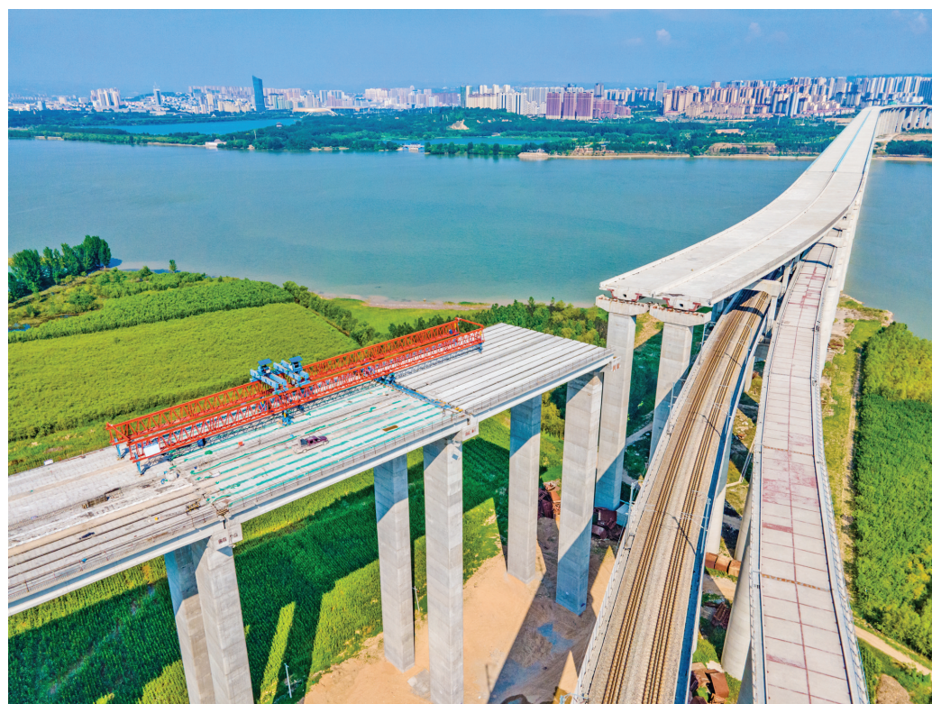
7月4日,运三高速三门峡黄河大桥连接线在加紧施工。 运三高速公路三门峡黄河大桥连接线全长15.16公里,位于中条山南麓,平陆县城以西。截至目前,运三项目路基土石方、附属工程均已完工,窑头特大桥主体工程已完成95%以上。项目完工后,将实现山西运城、河南三门峡两地高速公路网互通互联。 本报记者 陈方斌 摄
