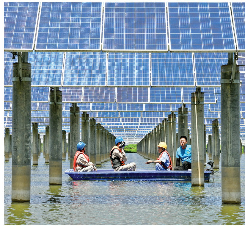
7月18日，在天津市宁河区，国网天津电力宁河公司运维检修人员在110千伏大月光伏电站进行年中检修巡查。该光伏电站建设在约3000亩的鱼塘上，让鱼塘形成了“水上发电、水下养鱼”的绿色生态养殖模式。新华社记者 孙凡越 摄
