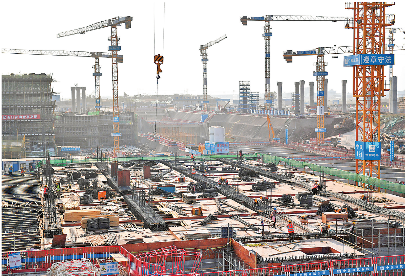
9月12日，中建五局的施工人员在长沙机场改扩建工程综合交通枢纽工程项目现场作业。中秋假期期间，在长沙机场改扩建工程综合交通枢纽工程项目现场，施工人员坚守岗位，保障工程进展顺利。新华社记者 陈振海摄
