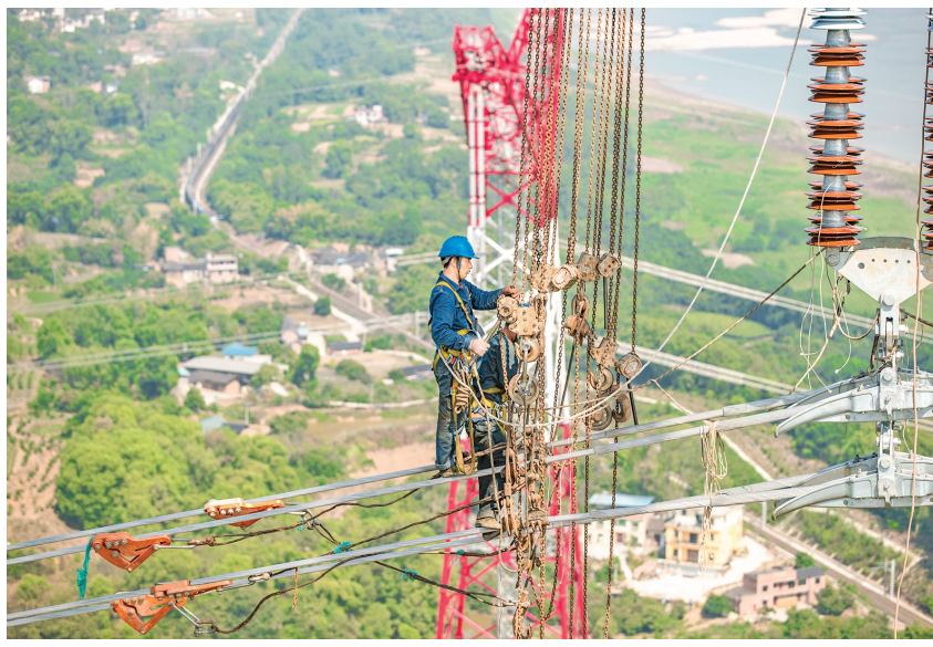
9月13日,工人在白鹤滩—浙江±800千伏特高压直流输电线路工程(重庆段)江津长江大桥施工现场作业。 白鹤滩是国家“西电东送”、清洁能源外送的重大电网工程,途经四川、重庆、湖北、安徽、浙江5省市,线路长度2140公里。
