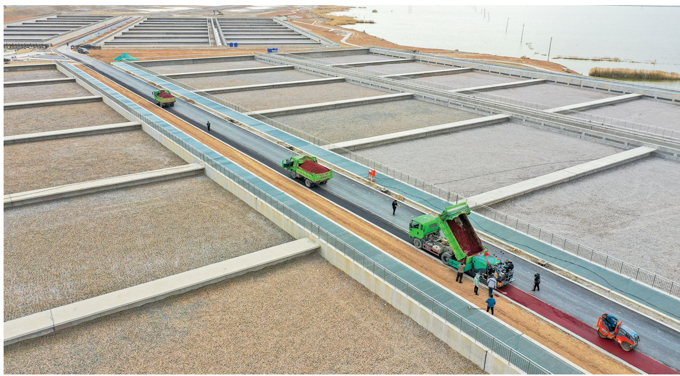
3月4日,鸭子池水生态综合提升工程建设现场,工人在紧张施工。近年来,我市持续加大生态环境保
