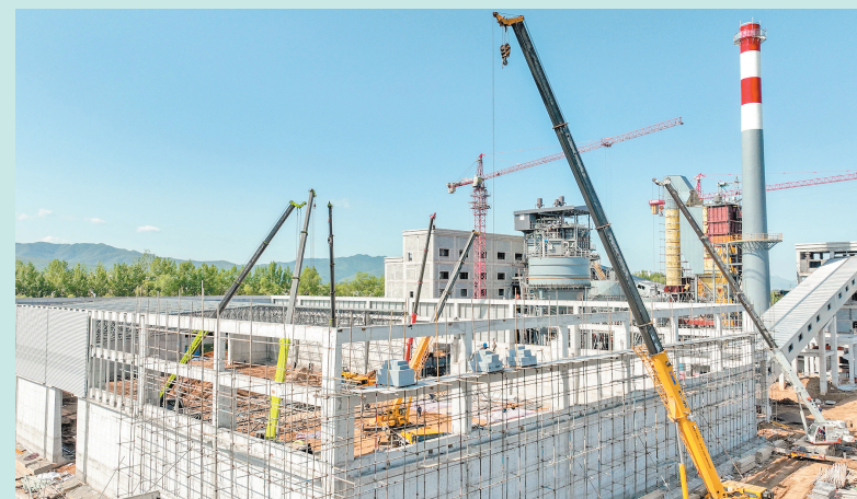
太锅集团低碳热能热力绛县有限公司项目
