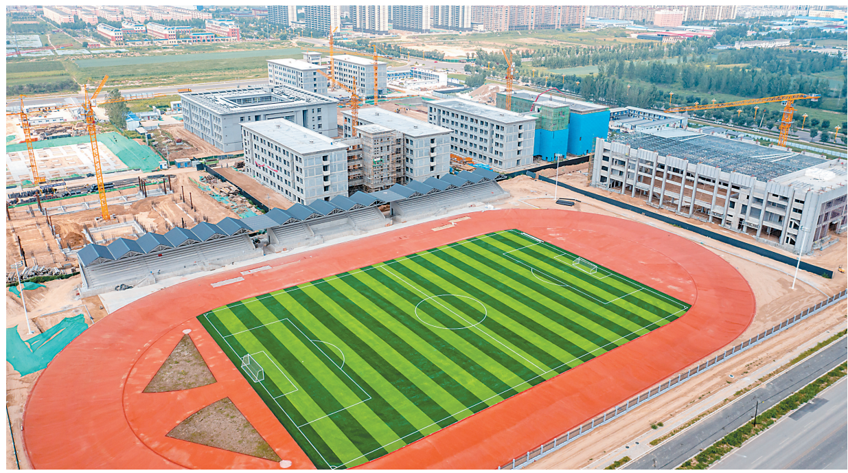
9月18日，万荣县万荣中学迁建项目建设现场，施工单位抓紧施工。
