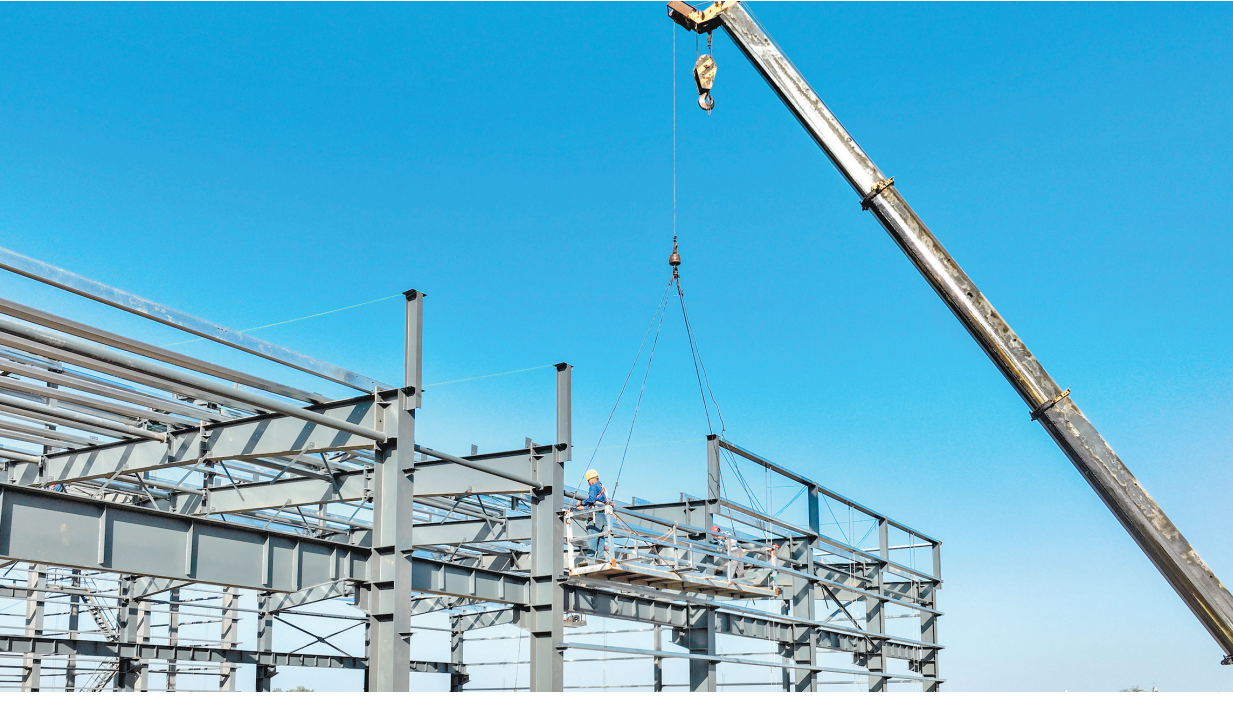
11月4日,位于绛县经济开发区的山西恒晖环保科技有限公司(危)废资源化预处理项目在加紧建设中。该项目总投资3亿元,今年计划投资1.3亿元,目前厂
