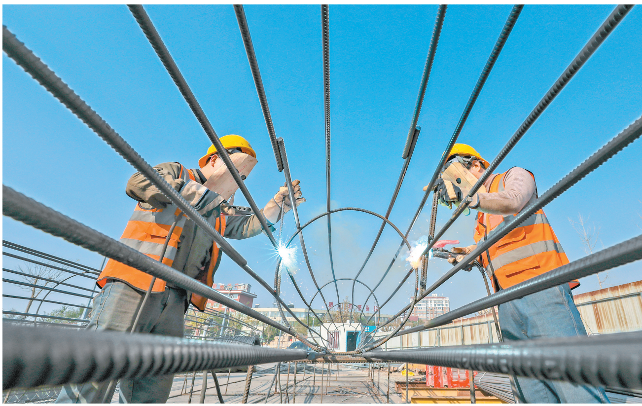
11月14日,电焊工人在稷山国家汾河湿地公园游客服务中心建设工地进行焊接作业。该中心建成后,将完善汾河湿地公园的基础设施配套,全面提升公园的服务质量。特约摄影 姜桦 文 格 摄
