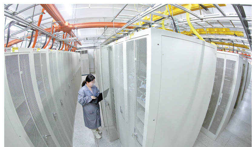
▲运城联通公司IDC数据中心维护员在机房检查数据安全,为5G发展与应用提供支撑。
