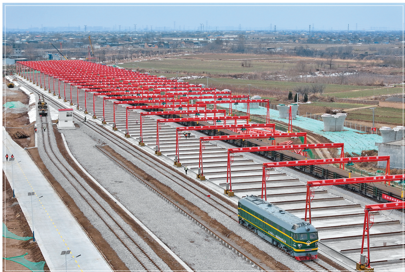
▲这是1月21日拍摄的中铁十一局西延高铁阎良辅轨基地（无人机照片）。
