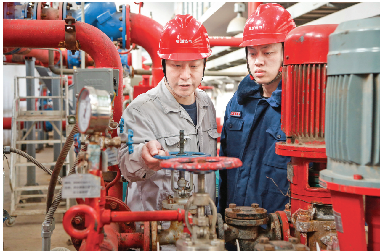
蒲洲热电公司近期组织安全联合检查组对生产重要场所进行安全隐患消防大排查,进一步压实安全生产责任,狠抓工作落实,坚决遏制各类安全火灾事故发生。
