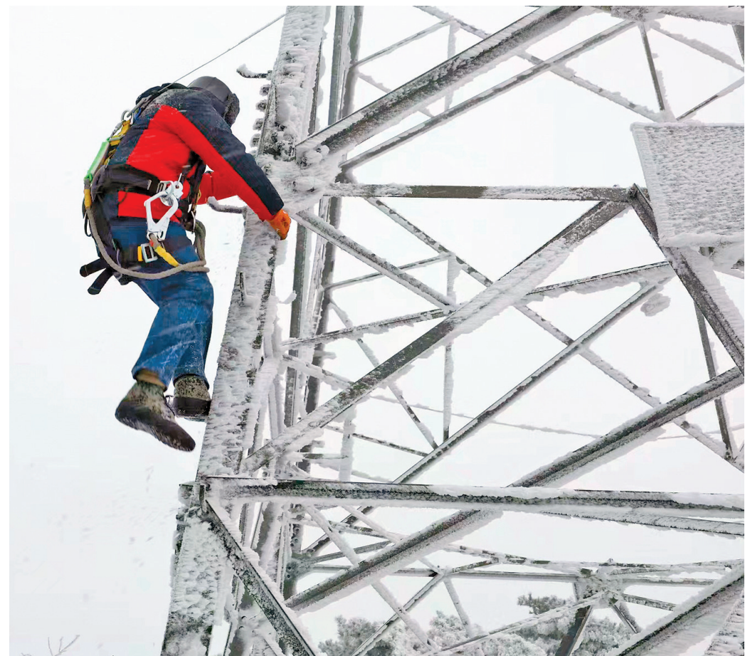
为应对低温雨雪天气,连日来,国网运城供电公司认真排查隐患,做好应急准备,组织人员在关键场所值守,设置11个固定观冰哨、11个流
