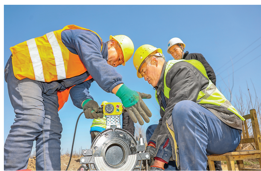
3月20日，在平陆县张店镇的新建水浇地项目施工现场，工人在焊接
