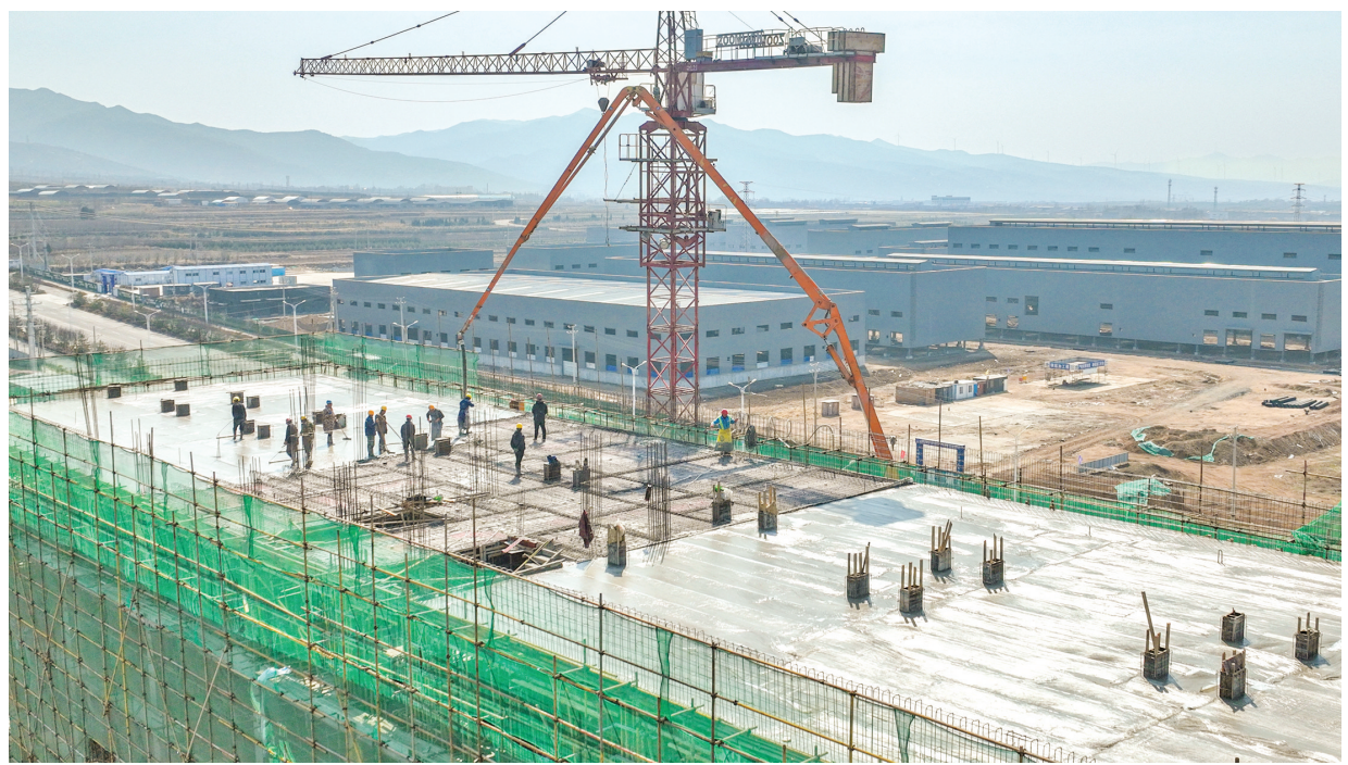
3月20日,位于绛县经济开发区的绛县建鼎新型建材有限公司新型环保超细微粉材料项目工地,施工人员在加紧建设。据了解,该项目占地50亩,投资2.18亿元新建年产60万吨超细微粉生产线一条,配套建设DCS控制中心、超细微粉成品仓、环保回收装置及辅助生产区。该项目建成后可实现年产值3亿元,增加就业岗位100余个。本报记者 金玉敏 摄
