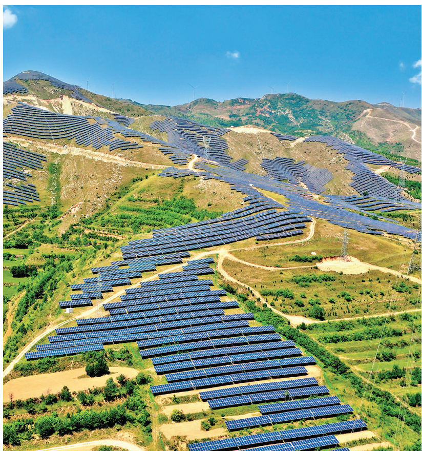
近年来，芮城县坚持生态优先，依托中条山荒山坡地优势和丰富的光热条件，逐步建成光伏先进技术示范基地、农林光互补示范基地、观光旅游示范基地。图为近日拍摄的芮城县光伏领跑技术基地光伏场区。特约摄影 郝健 摄
