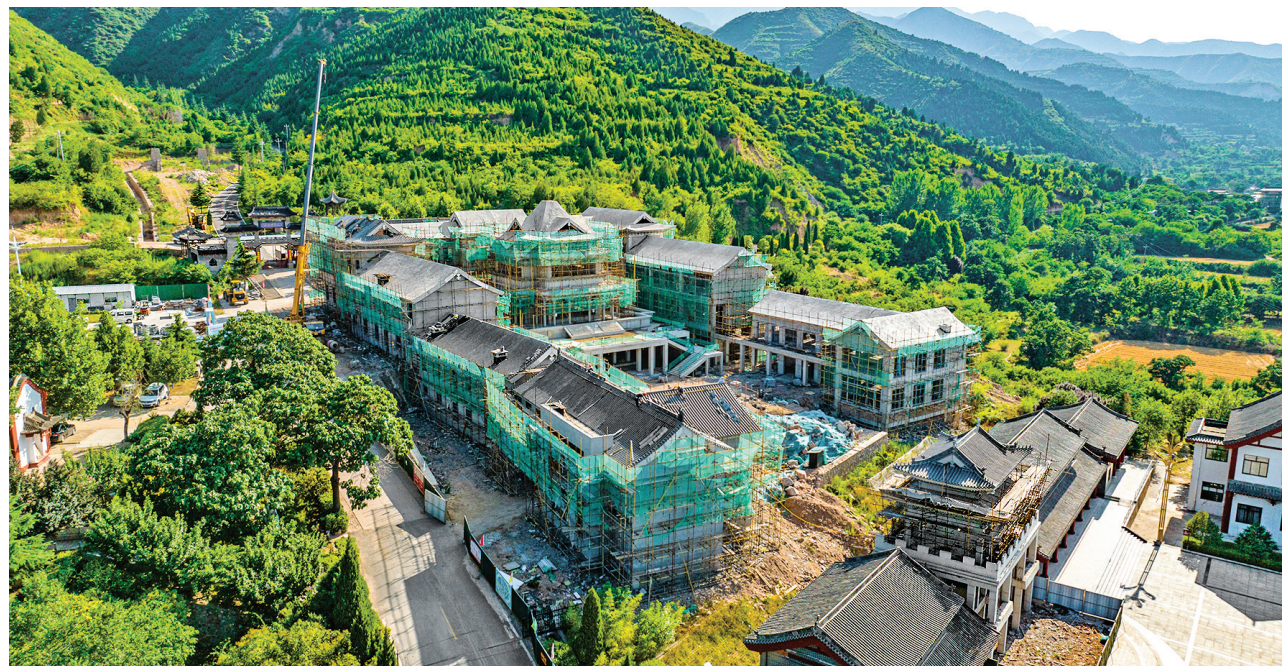
6月17日,永济市五老峰景区创建国家5A级旅游景区建设项目河洛源文化馆在加紧建设中。五老峰景区创建国家5A级旅游景区建设项目是我市重大文旅建设项目,总投资6.17亿元,包括六大类58个子工程。项目建成后,将进一步完善景区基础设施,提升景观质量,丰富业态布局,对全面推动文旅融合发展、促进产业转型升级、加强黄河文化保护传承弘扬具有重要意义。本报记者 陈方斌 摄
