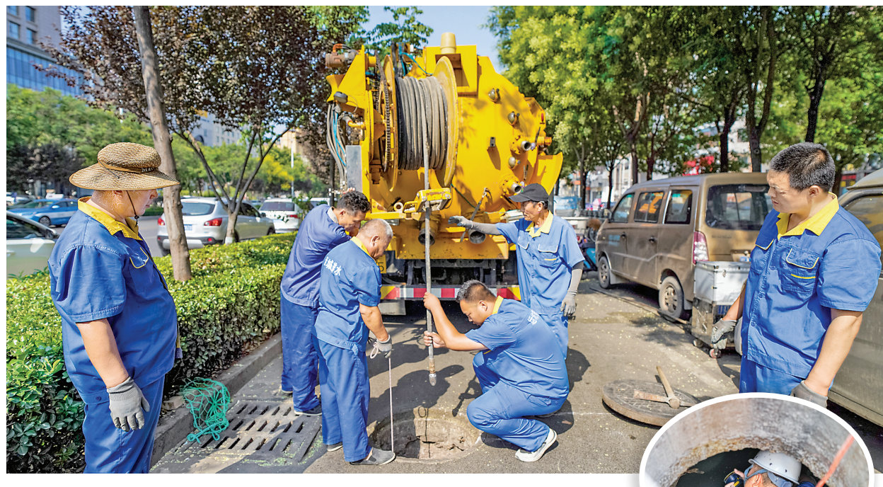
▲市城市管理局排水服务中心工作人员在条山街留驾庄村村口附近对排水管网进行排查。
