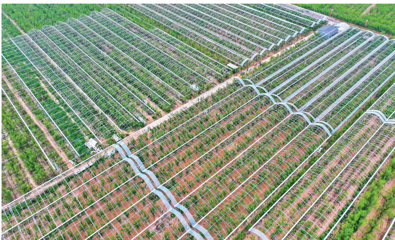
7月10日，稷山县板枣示范园，施工人员在搭建防雨棚。稷山县采取示范引领助力板枣产业发展模式，积极建设板枣标准化示范园，投资1300万元建设150亩钢架防雨棚及水肥一体化、智慧监测管理平台，进一步增强板枣综合防控灾害能力，提高稷山板枣的产量和品质，实现高产、
