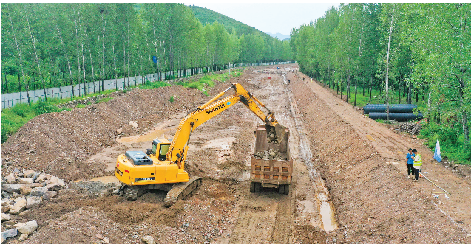
8月4日，在当前防汛关键期，夏县白沙河水源保护与治理修复项目工程工地，工人驾驶大型机械车辆进行河道疏浚等施工作业，提升抗洪
