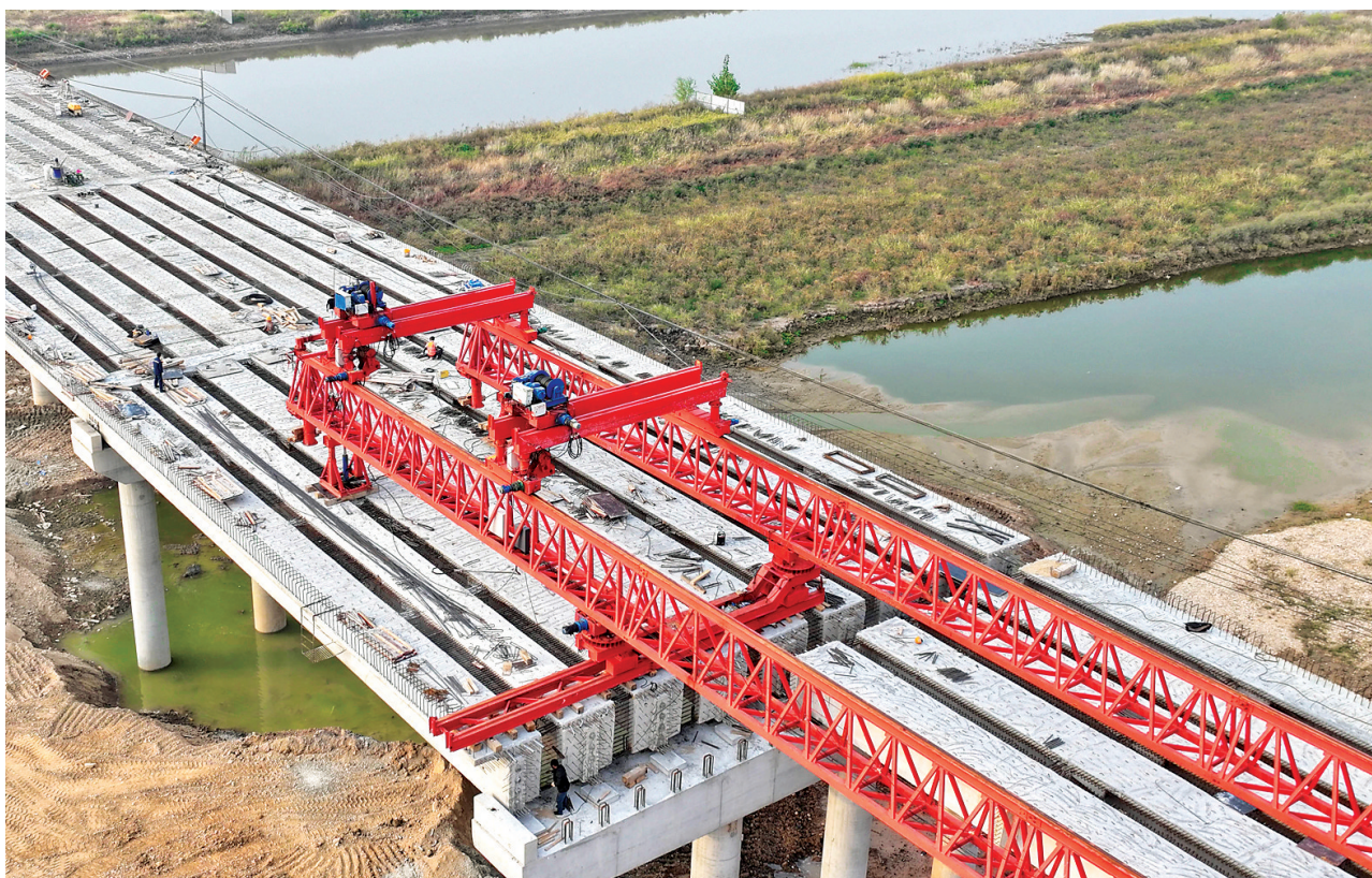
近日,工人在稷山县云仁线汾河大桥改建工程项目现场施工。据悉,该大桥桥梁全长396米,上
