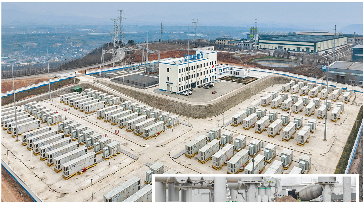
上图 中核汇能山西能源有限公司垣曲储能电站200兆瓦/400兆瓦时现代自动化独立储能项目现场。
