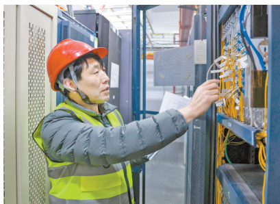
▲移动公司工作人员检查机房负荷
