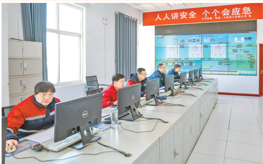
▲中环寰慧垣曲节能热力热源厂中控大厅内,全体人员严阵以待。
