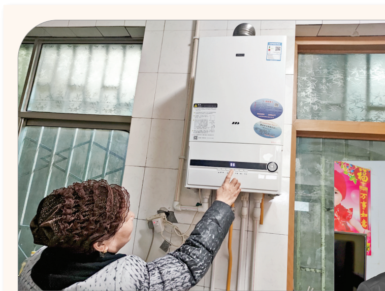
▲居民调试壁挂炉 记者 赵雪 摄
