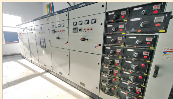
▲全自动化控制室
