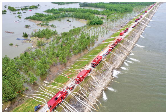
▲7月9日, 在湖南华容县团洲垸洞庭湖大堤, 排涝作业正在进行中。随着湖南华容县团洲垸洞庭湖大堤决口完成封堵, 消防、应急等部门抢险人员抢抓时间在多个点位开始对团洲垸进行排涝作业。 新华社记者 陈思汗 摄
