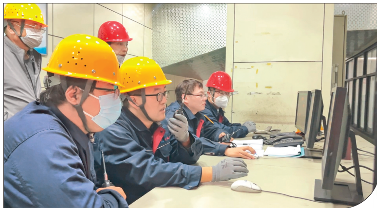
▲中控室工作人员查看机组数据
