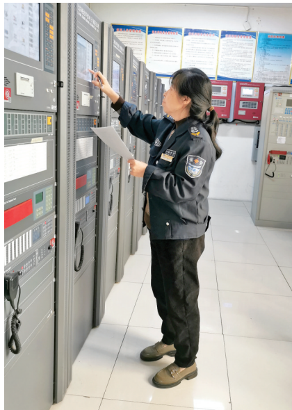
▲消防操作员记录消防主机运行情况
